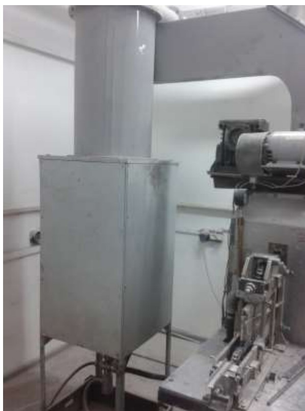
Рис. 14. Смонтированная на установке система регенерации абразивного материала
