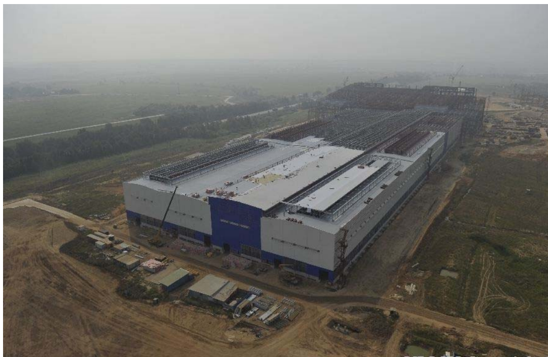
Рис. 1. КНПЭМЗ (вид сверху)
